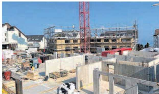
Stand der Bauarbeiten vor rund drei Wochen: Zwei der insgesamt vier Holz-Wohnhäuser nehmen langsam Gestalt an.
